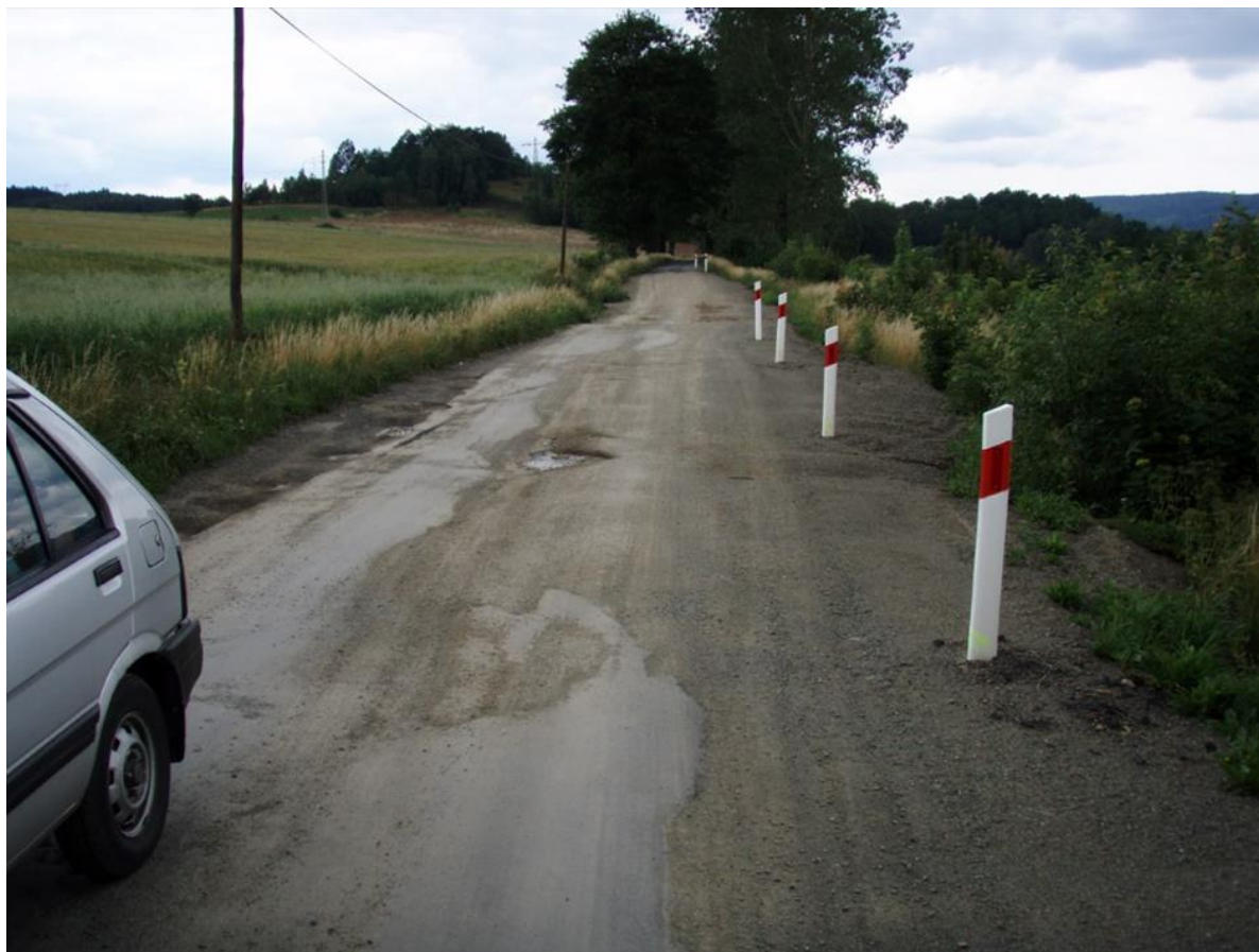
Ryc. 22 Niszczony przez dziesięciolecia fragment drogi Ciechanowice – Miedzianka wskutek zsuwania przypowierzchniowej partii gruntu (fot. M. Kasprzak, 2007).
